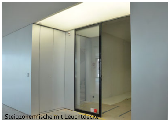
Steigzonennische mit Leuchtdecke
